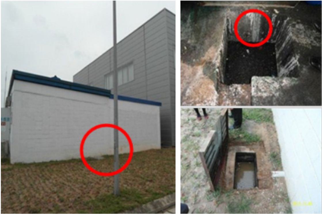
폐화학물질 저장소(왼쪽), 폐화학물질 저장소 내부의 집수조(오른쪽 위), 저장소 내부의 집수조와 연결된 외부 배수구(오른쪽 아래).
