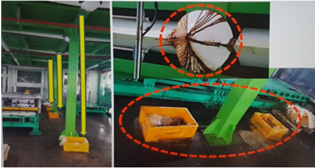
삼성 호치민 공장의 2층 화학물질 공급실에서 화학물질이 누출되어 천장을 통해 1층으로 떨어지고 있다. 화학 물질을 모으기 위해 노란색 용기가 놓여 있고 용기 주변이 오염되어 있다.
