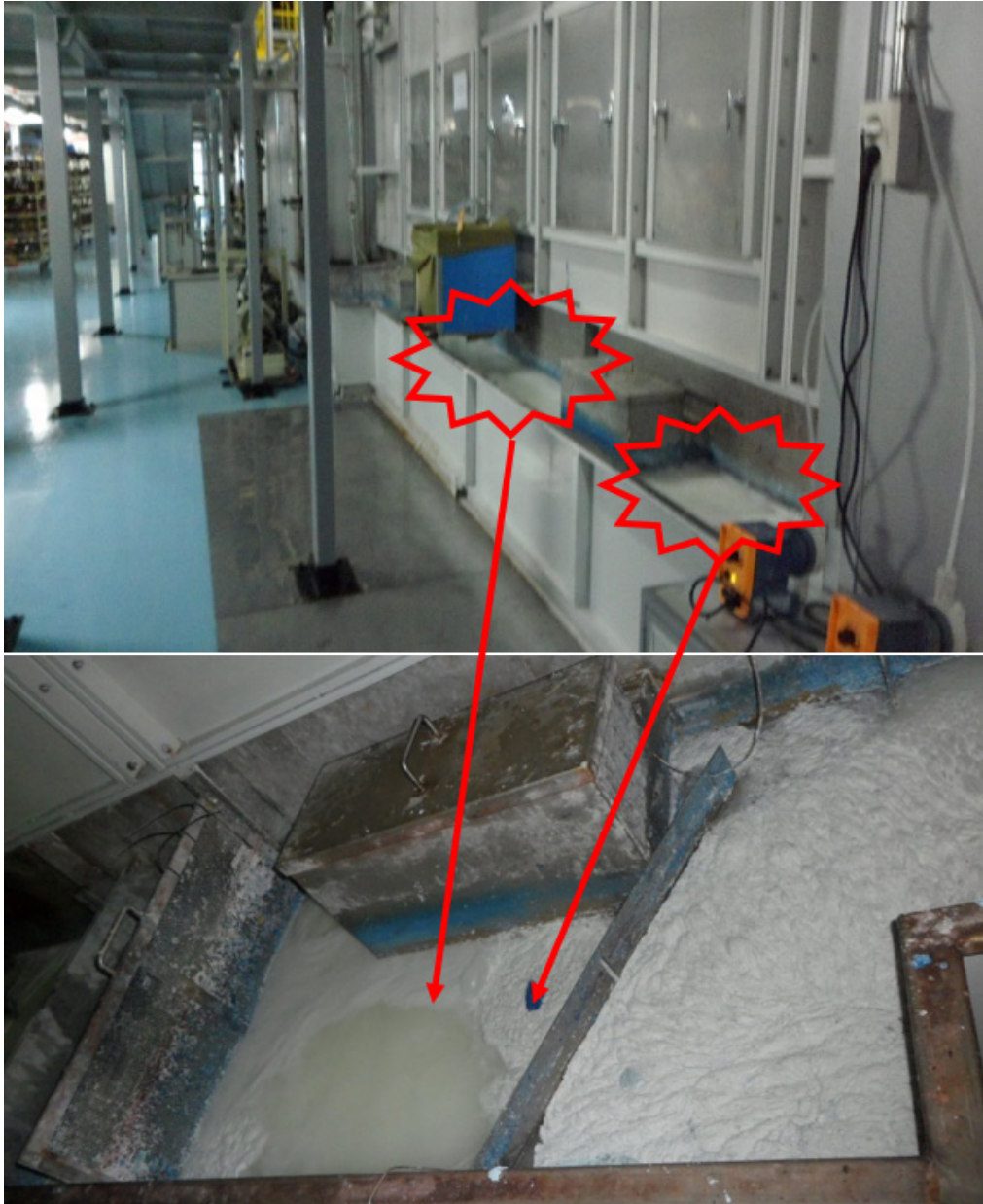
삼성 베트남 박닌 공장의 도장 공정에서 페인트 스프레이 폐수 처리 구역에 국소 배기 장치를 설치하지 않아 독성 화학물질이 방출되고 있다.
